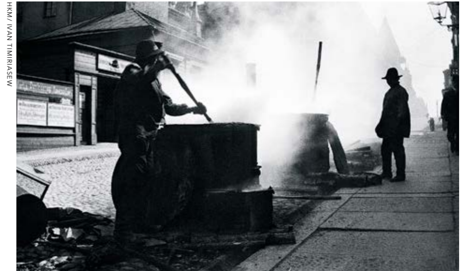
Katujen päällystäminen eteni tasatahtia autoistumisen kanssa. Asfalttia kuumennetaan kadunrakennustöissä 1910-luvulla Helsingin Korkeavuorenkadulla.
